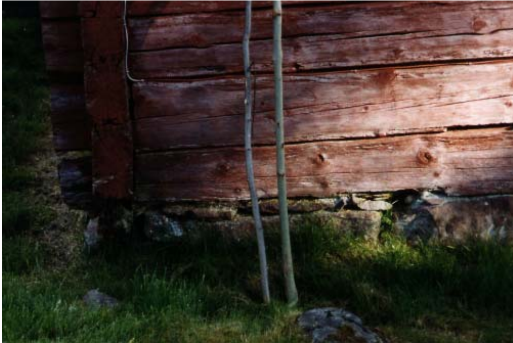
Råsjö 1:16, detalj av skadad syll, från väst
