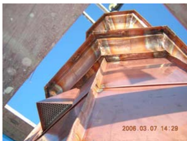
Den nya luftningshuven
