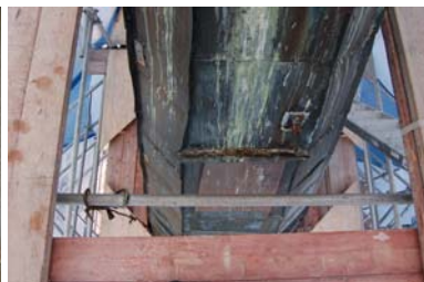
Tornhuv före åtgärd
