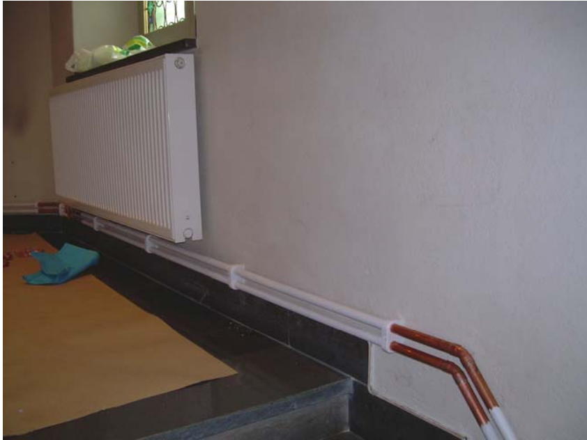
2008-02-28. Rörledning och nya radiatorer utmed södra väggen vid koret.
