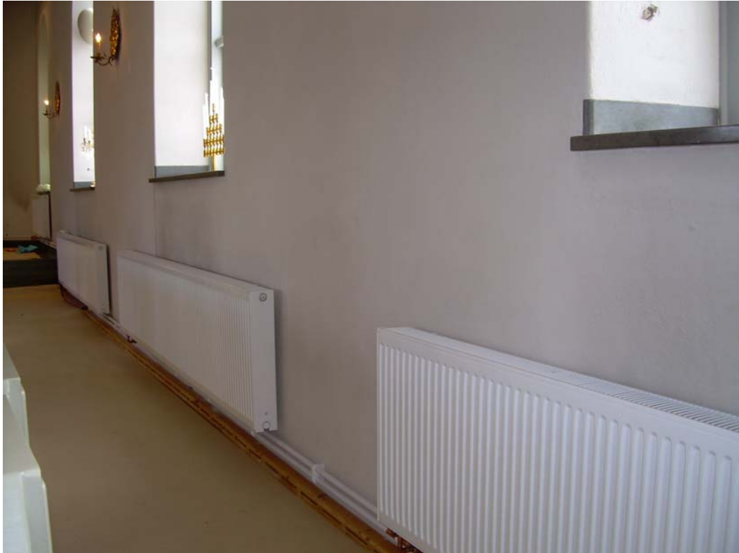
2008-02-28. Nya vattenburna radiatorer vid södra väggen. Radiatorerna är placerade så nära golvsockeln som det är möjligt .
